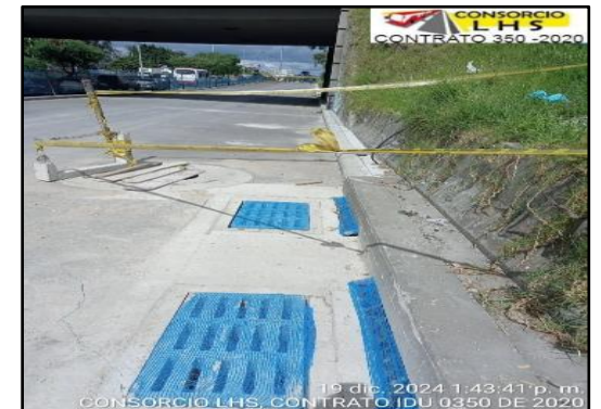
Foto : Protección de sumideros de aguas lluvias
