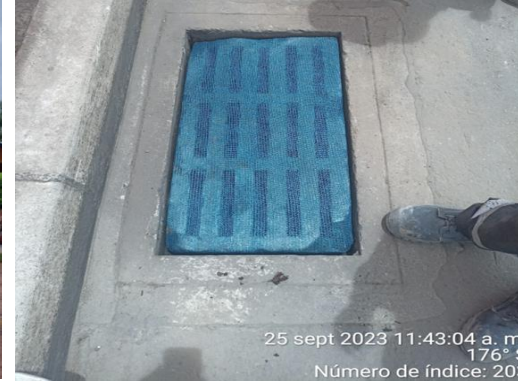
Foto : Protección de sumideros de aguas lluvias
